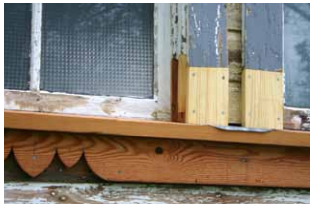
Église anglicane St. Paul, région de St-Francois-Xavier (Manitoba). Les nouveaux matériaux devraient être compatibles visuellement et physiquement avec les anciens.
